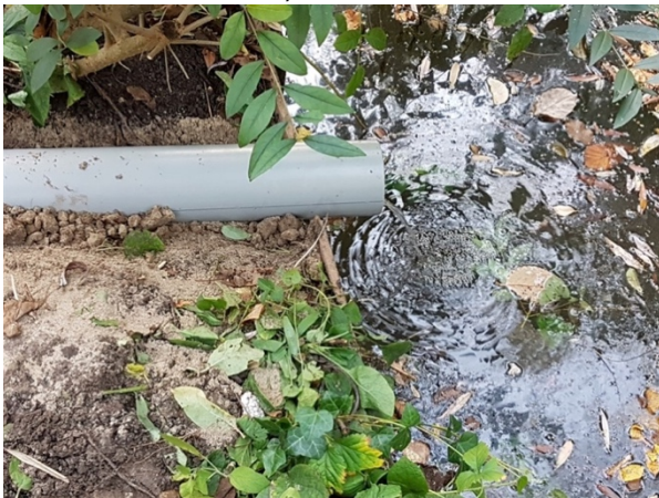
Figuur 10.15: Regenwater wordt afgevoerd naar nabijgelegen sloot (Kennisportaal Ruimtelijke Adaptatie, 2018).
