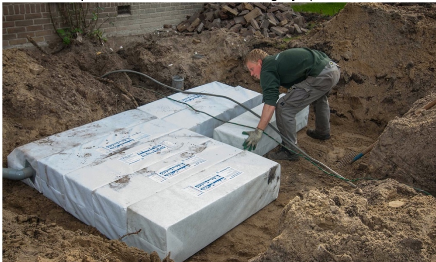
Figuur 10.11: Het afkoppelen van de regenpijp aan de meerdere Hydroblob-blokken in de Prinses Marijkestraat in Amsterdam (Michon, 2016).
