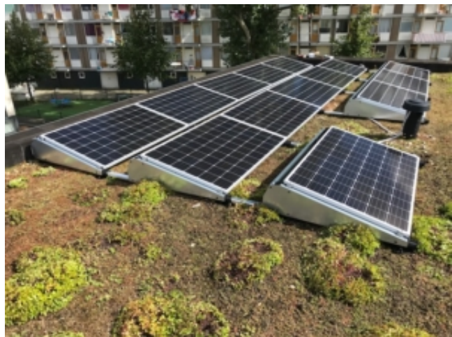
Figuur 9.10: Zonnepanelen op een sedumdak (Green Energy Company, 2020)
